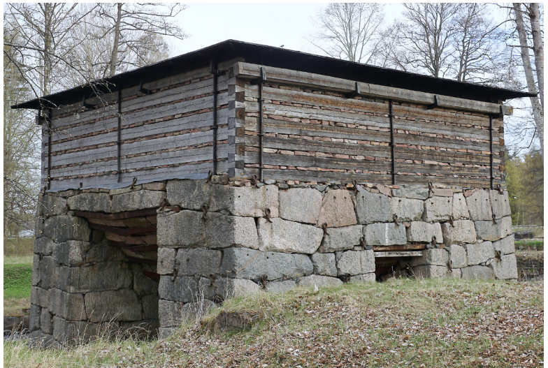
Ruin av masugn i Gysinge. Pipa och isolering skyddade av ett tak.
