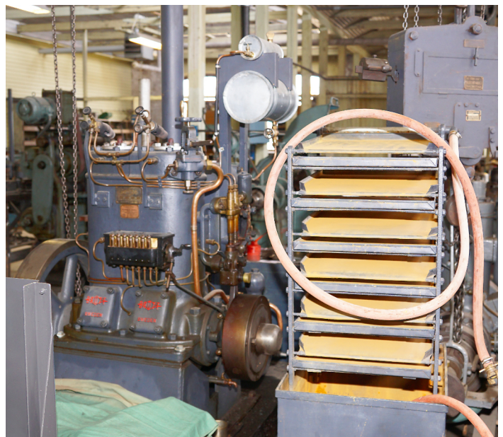
Tvåcylindrig Drott-motor av typ SE-2. Till höger står en kylare av den typ som ersatte snörkylaren. Kylvattnet pumpades ut längst upp och vattnet rann utefter snedställda plåtar tills det avkylt samlades upp i kylvattentanken längst ner.
