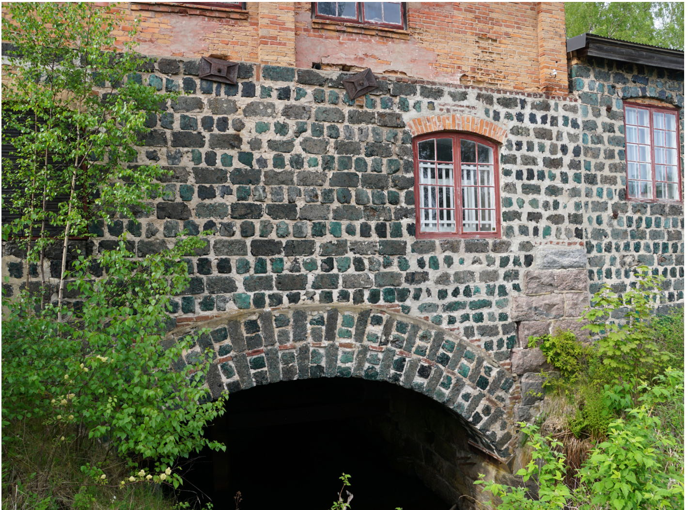
Vägg som till undre delen är murad med slaggsten. Se hur tegelväggen är i betydligt sämre skick.
