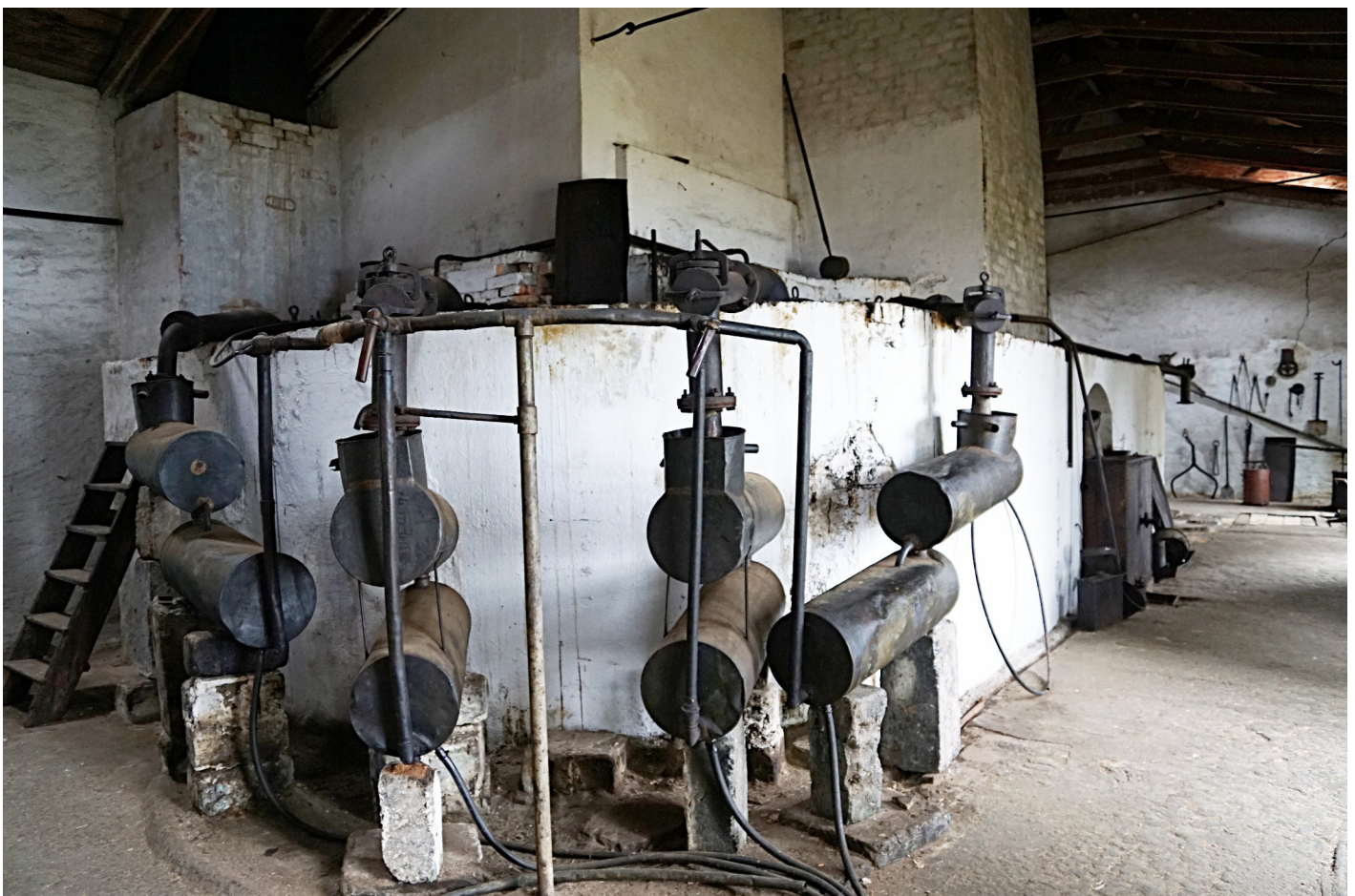
En del av destillationanläggningen. Bakom den vita muren finns fyra dolda retorter, framför muren syns fyra kylare. Den destillerade oljan rinner ut genom de små slangarna i botten av kylarna.
